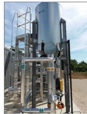
Photographie 22 : Filtre à charbon actif (Source : agriKomp)
