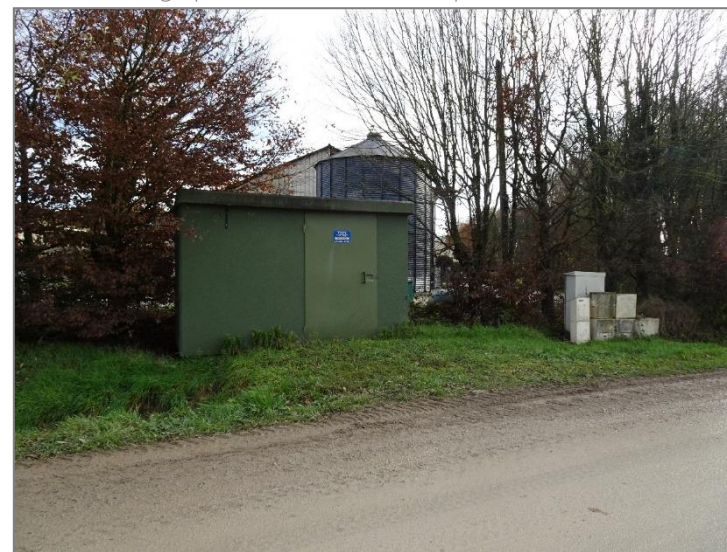
Photographie 9 : Vue du poste électrique localisé à proximité de l'entrée du site
